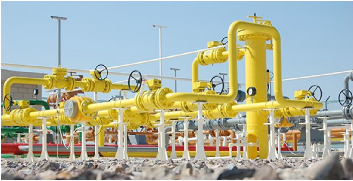
Medidores FMG, estación El Difícil de Gases del Caribe, Gasoducto de 8 pulgadas Magdalena - Cesar. El Heraldo (Fotografía).
