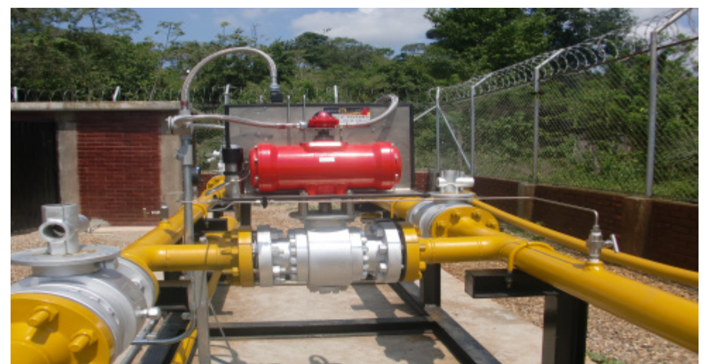
Sistema instalado en Progasur
